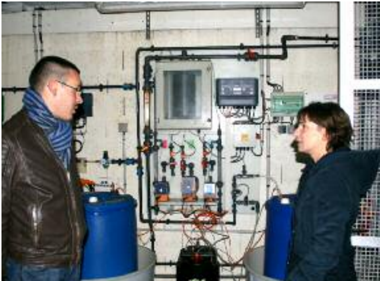
Contrôle du système de chloration du Château d'eau.
